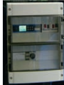
LPP21 monteret i et kabinet
